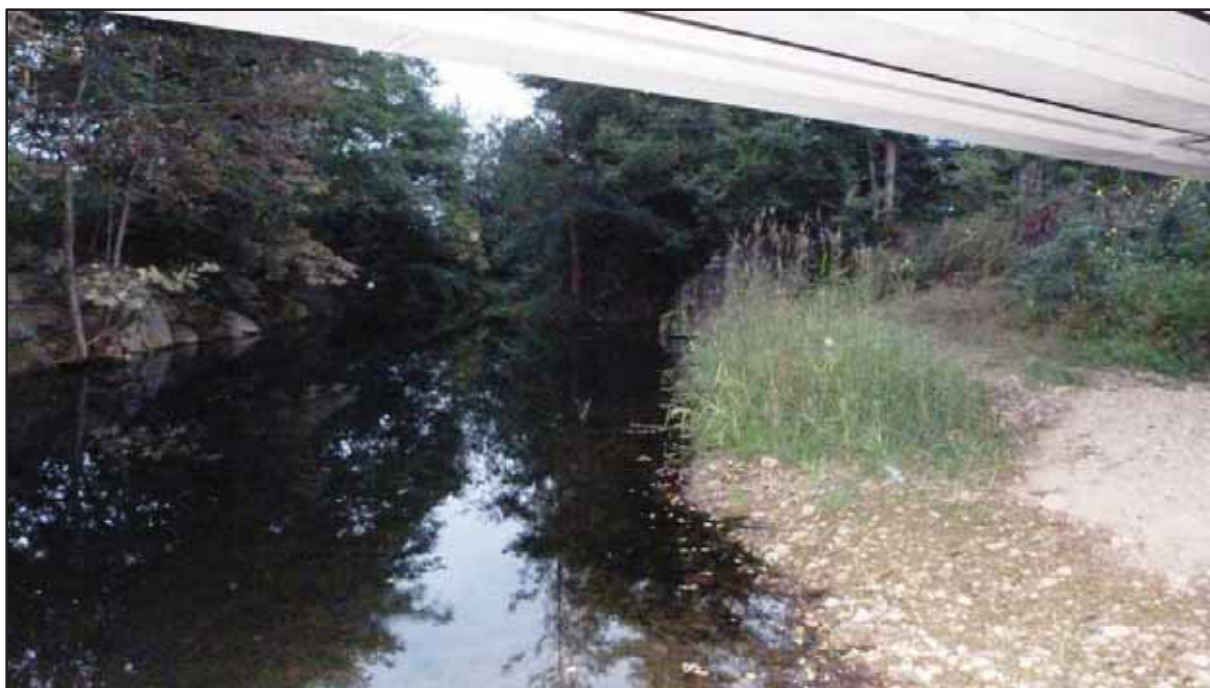
Figura 253 - Interruzione lungo la sponda sinistra idrografica del torrente Terdoppio, nel tratto sottostante la SP17.
