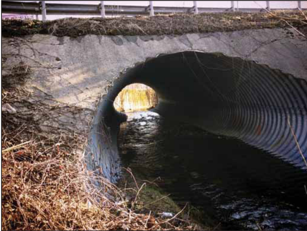
Figura 78 – Passaggio in lamiera grazie al quale il fosso Geola scorre sotto la SR142 Biellese.
