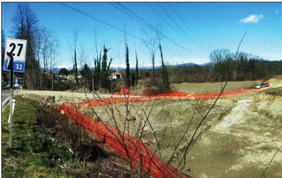
Figura 208 – Area di cantiere per la realizzazione di un nuovo raccordo stradale che si collegherà alla SS32 Ticinese con una rotatoria stradale in corrispondenza dell'intersezione con la SP166.
