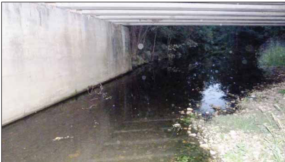
Figura 252 – Interruzione lungo la sponda destra idrografica del torrente Terdoppio, nel tratto sottostante la SP17.
