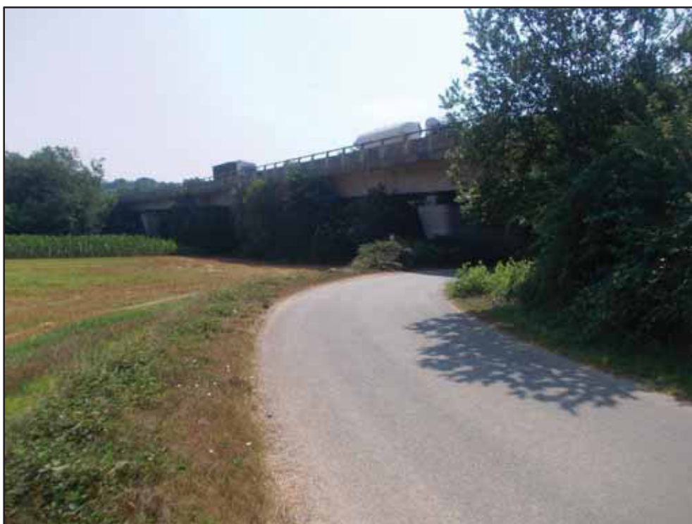
Figura 118 – Vista settentrionale del viadotto Lirone della A26-Genova Voltri/Gravellona Toce, in corrispondenza del varco V18- Borgomanero/Cressa.
