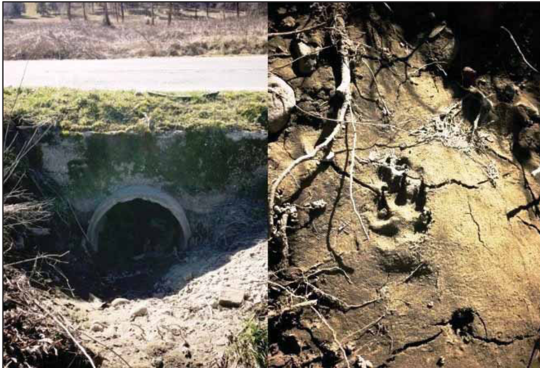
Figura 210 – Canalizzazione di scolo di dimensioni ridotte sotto la SS32 Ticinese (a sinistra) occasionalmente utilizzata per il passaggio da parte di volpe (a destra).
