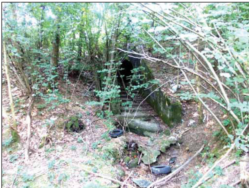
Figura 113 – Raccordo con il fondovalle della canalizzazione a valle della SP142; sono evidenti alcune locali situazioni di degrado legate all'abbandono di rifiuti.
