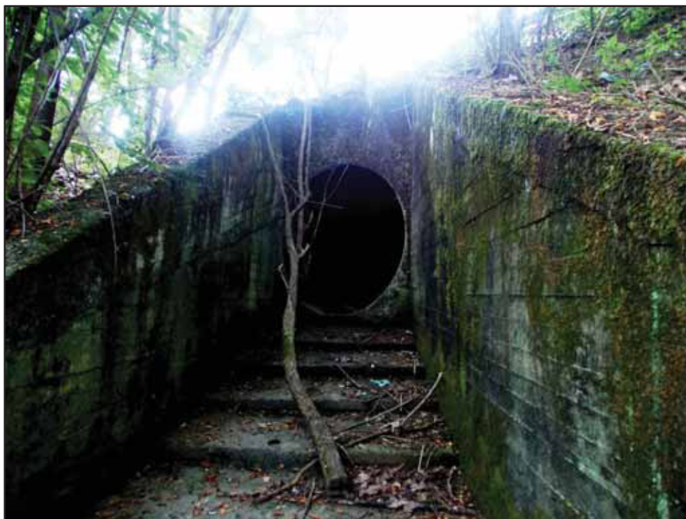
Figura 112 – Tratto finale della canalizzazione che convoglia a valle della SP142 le acque meteoriche raccolte dall'impluvio a monte.
